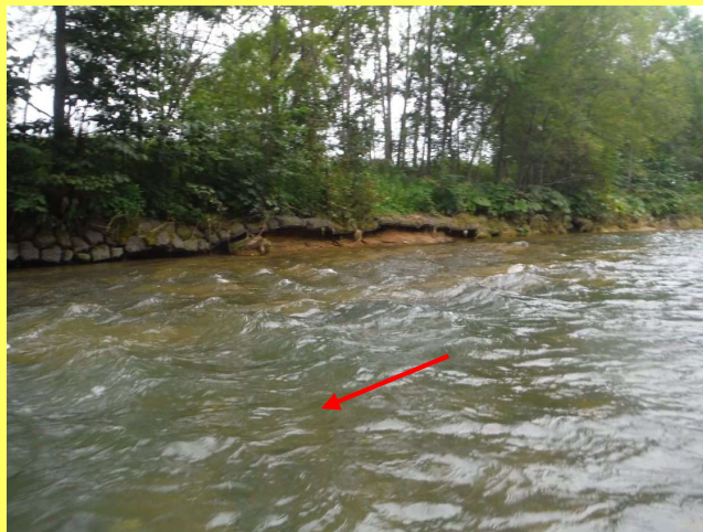
無加川 河床低下状況（北進大橋下流） ＜令和4年8月＞
